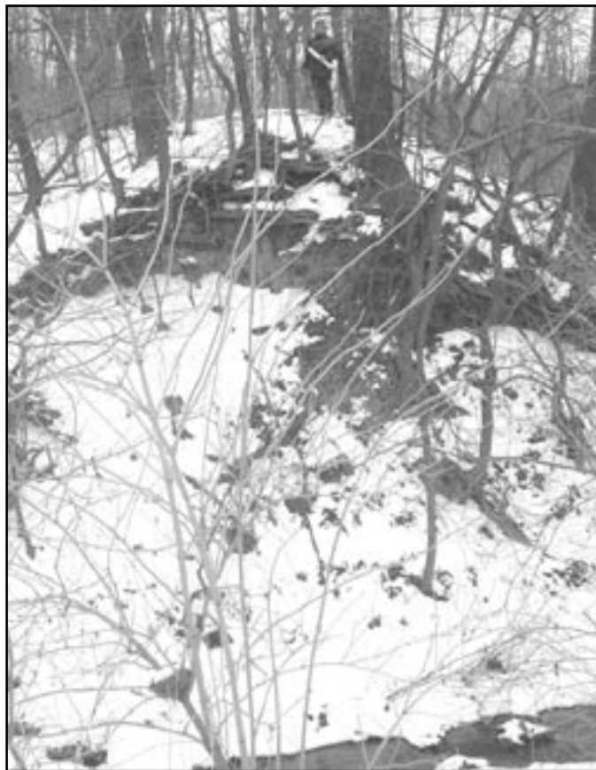
Protržená hráz horního štěpánovského rybníka. Výšku hráze (téměř 10 metrů) můžete porovnat s postavou stojící na vrcholu.
